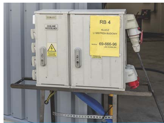
Rozdzielnica zabezpieczona przed dostępem osób nieuprawnionych.
